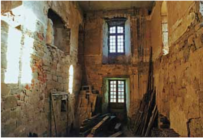
Salles nord, rez-de-chaussée et premier étage, état lors de l'étude préalable à la restauration: le plancher intermédiaire a disparu, des restes d'enduit de différentes époques sont présentes sur les murs
