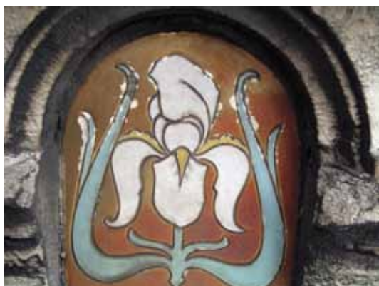
Zone présentant des écaillages et nécessitant une consolidation par infiltration de résine
