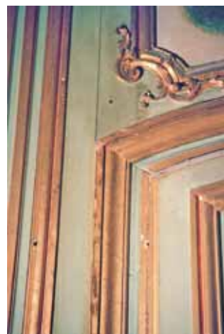
Détail du mauvais état de présentation de la boiserie, encrassement, lacunes à l'intérieur desquelles on aperçoit la couleur rose originale
