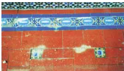
Frise, cabochons et dalles rouges du carrelage avant la dépose: on observe les écailles manquantes, le sable sortant par les joints et la colle du tapis recouvrant les surfaces
