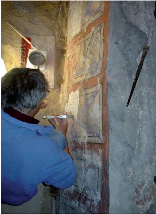
Fig. 5 A en B : Luik/Tongeren, graftombe van Koninksem (4de eeuw) : tijdelijke bescherming met cyclododecaan (vluchtig bindmiddel) en afdekkende facing om de verdamping te vertragen tijdens het injecteren van het onderliggend metselwerk met epoxyhars.
